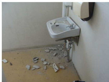
トイレの壁も崩れ落ちている
